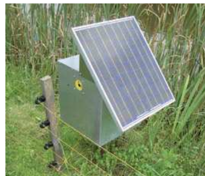
Figure 15 : Batterie fonctionnant à l'énergie solaire (COLLECTIF 2010).
